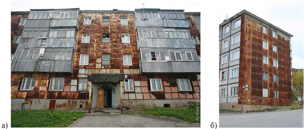
Рис. 2. а) «ржавый фасад» жилого дома Петропавловска-Камчатского [17]; б) «ржавый фасад» в торце жилого дома Петропавловска-Камчатского [18].
